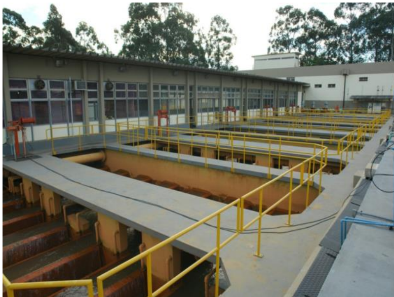
Figura 3-48 - Estação de Tratamento de Água de Vale Esperança – ETA Nova.
