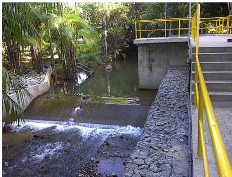
Figura 3-53 - Captação de água bruta no Rio Santo Agostinho.
