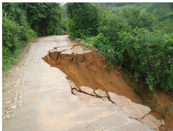
Figura 3-9 - Estradas danificadas pela chuva.
