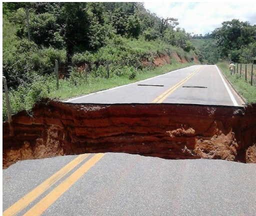
Figura 3-7 - Estradas danificadas pela chuva.
