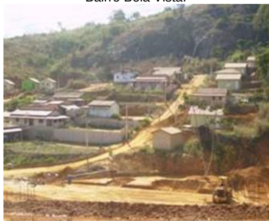
Figura 3-10 - Área de desmoronamento – Bairro Bela Vista.
