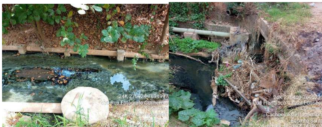
Figura 2-39 - Córrego Coramara, sub-bacia do Valão. Presença forte de esgotos nas águas. Tubulação de esgotos, atravessa o córrego, propiciando a retenção de galhos.
