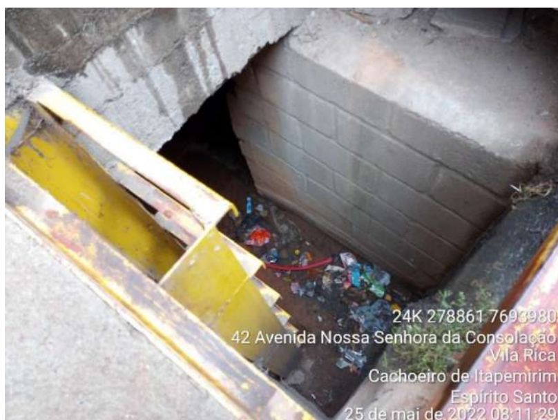
Figura 2-37 - Bacia Vila Rica. Caixa de passagem de águas pluviais na Av. N. Sra. Da Consolação (próximo a Vinox), presença de esgotos nas águas.
