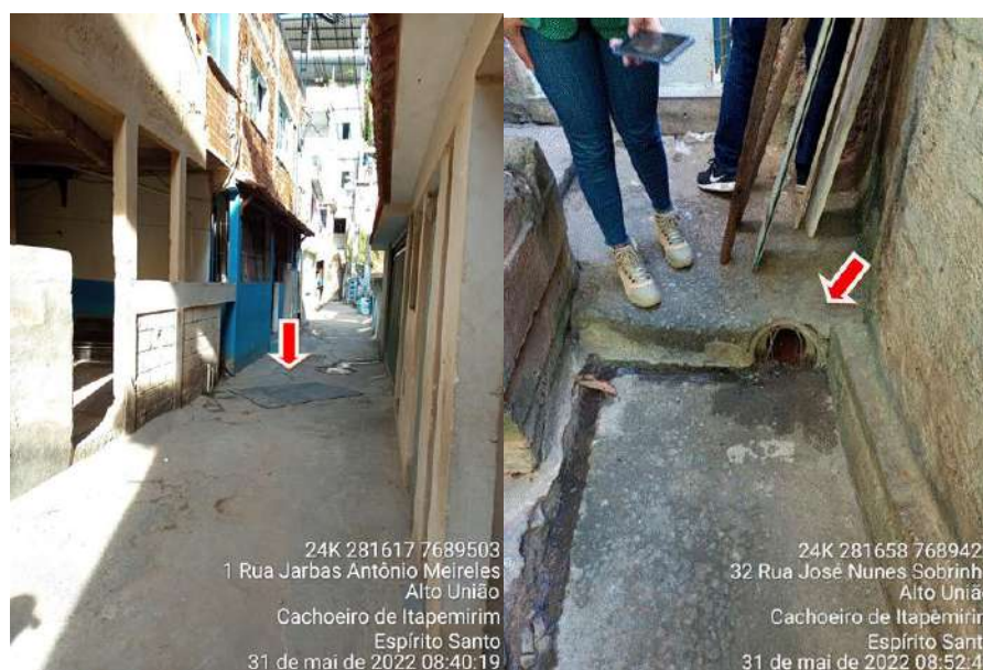
Figura 2-30 - Bacia Alto União. A população cobre as caixas de coleta de águas pluviais devido ao cheiro proveniente dos esgotos. No Beco João Moreira, a água pluvial e esgoto escoam pelo beco e escadaria durante as chuvas.
