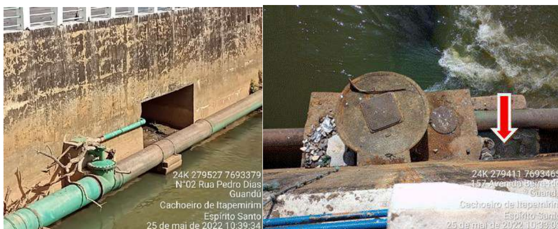
Figura 2-35 - Bacia Campo da Leopoldina. A Bacia tem duas fozes para o rio Itapemirim, ambas obstruídas pelo interceptor de esgotos. A seta vermelha indica que a água em fluxo normal, bate na tubulação e escorre pela lateral.
