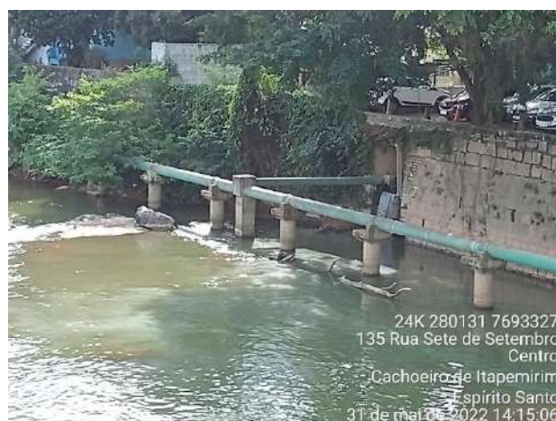
Figura 2-42 - Foz da Bacia Ferrovários, com presença de esgotos nas águas. Existência de estruturas de esgoto dentro da galeria. O relevo do Ferrovários não justifica a rede de coleta de esgoto ser dentro da rede de drenagem (como em outros casos em que a cota da saída de esgoto das casas está no nível do canal de drenagem).
