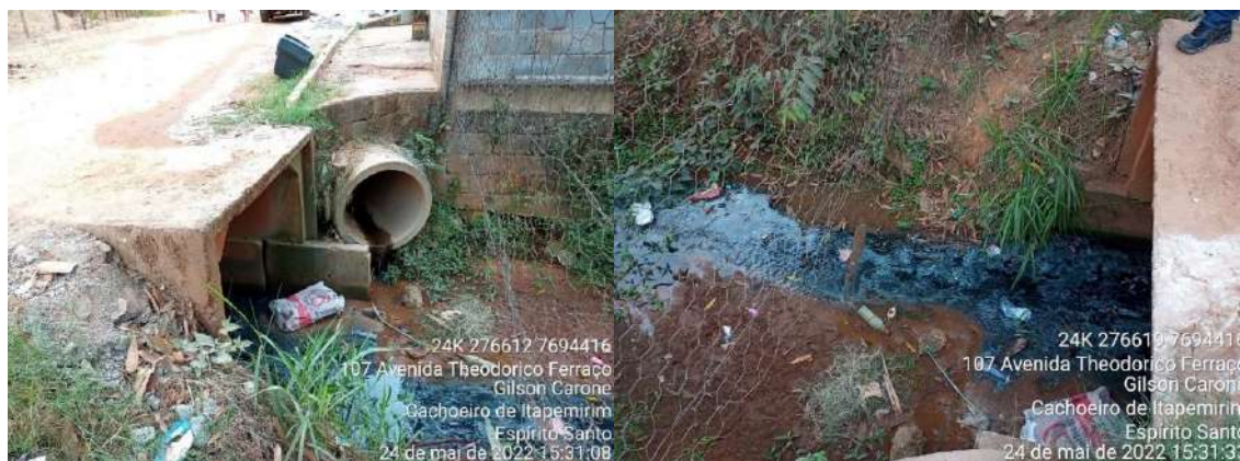
Figura 2-40 - Córrego Gilson Carone, sub-bacia do Valão. Muito esgoto nas águas
