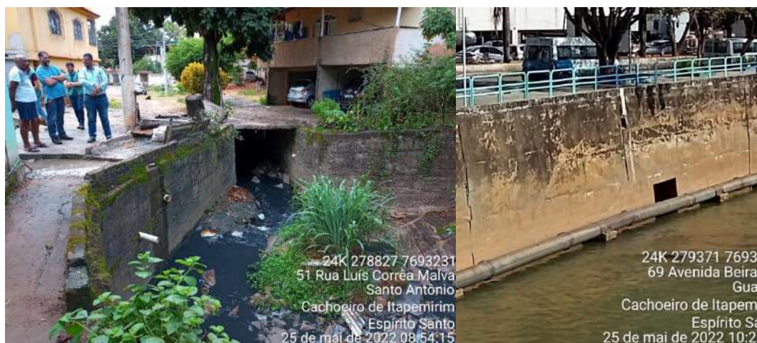
Figura 2-36 - Bacia São Francisco. R. Sergipe, Início da canalização do córrego, muito esgoto na água. Foz do córrego no rio Itapemirim, parcialmente obstruída pelo interceptor de esgotos
