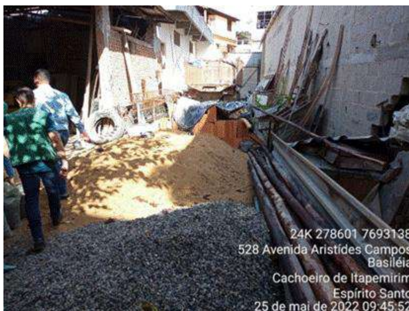
Figura 2-63 - Córrego São Francisco, neste trecho recentemente canalizado, foi transformado em depósito de um material de construção.
