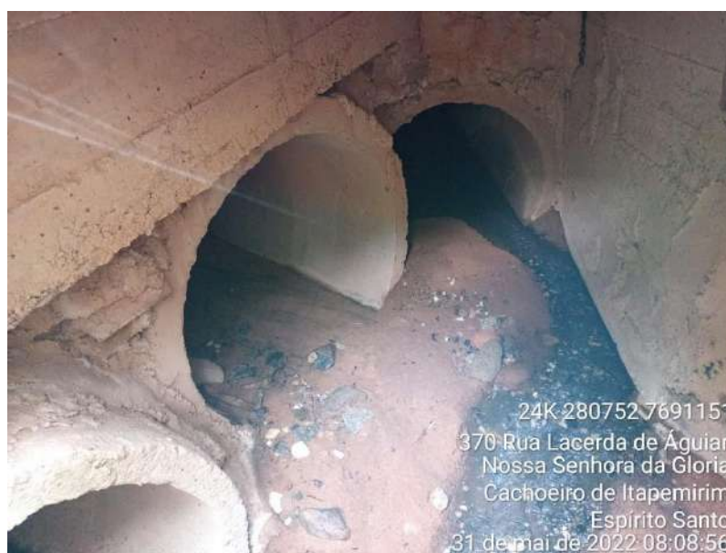
Figura 2-32 - Bacia Nossa Senhora da Glória. No interior da caixa de passagem de águas pluviais, escoamento contínuo de esgotos.
