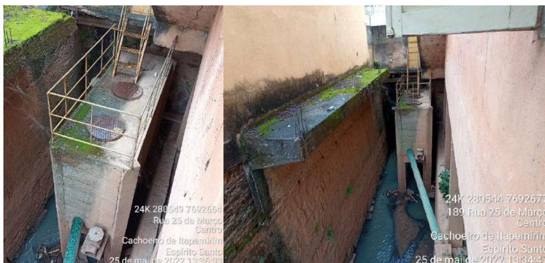
Figura 2-34 - Bacia Amarelo. No trecho final para a foz, estrutura do sistema de esgotos diminui significativamente a seção do Córrego Amarelo. Esgotos nas águas.
