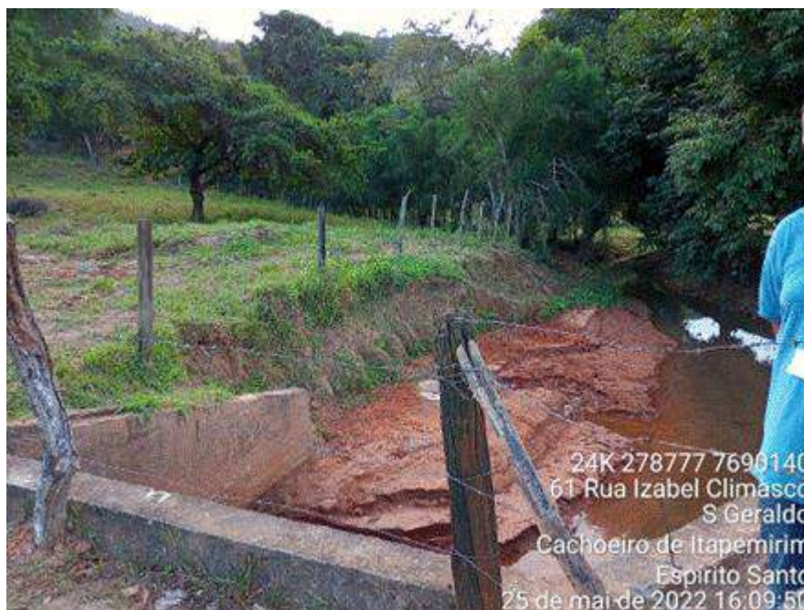
Figura 2-69 - Trecho do córrego Amarelo com muitos sedimentos vindos da obra de terraplenagem do loteamento que está sendo implantado.
